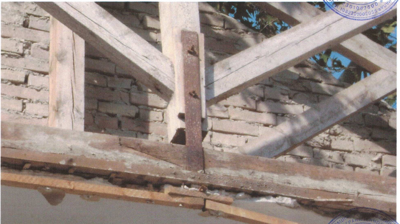
Фото №20. Узел усиления нижнего пояса фермы-металлическая стремянка.
