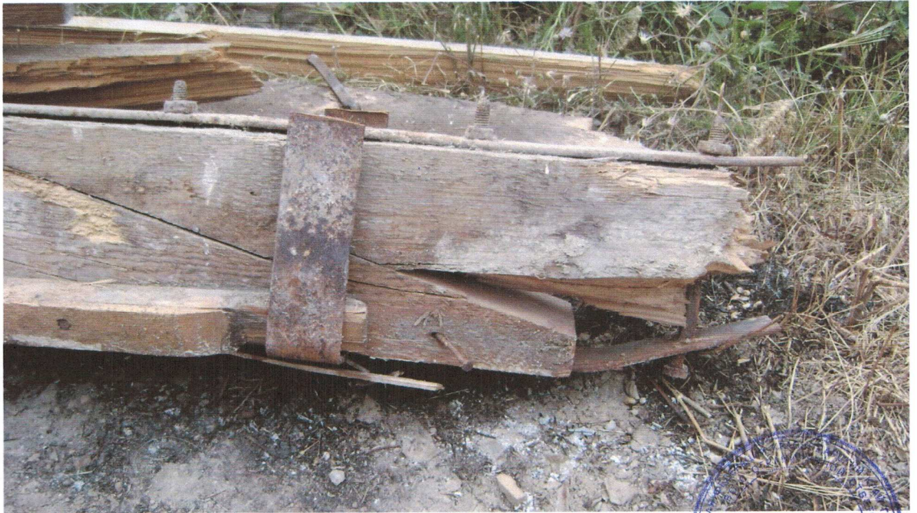
Фото №25. Место излома несущей деревянной балки.
