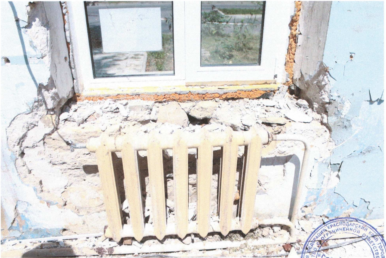
Фото №17. Здание спортивного зала после начала производства ремонтных работ съемка июль 2014 года.
