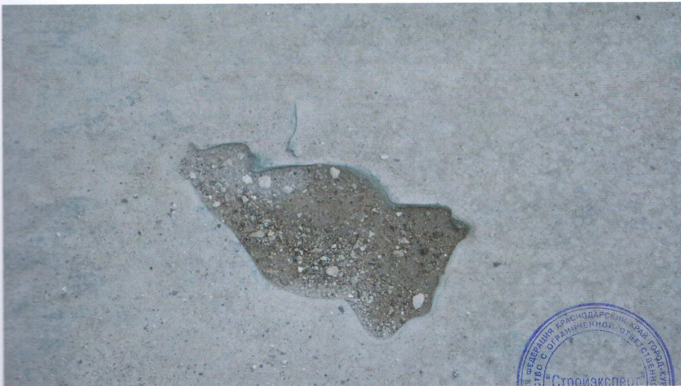
Фото №33. Место повреждения каучукового покрытия пола.
