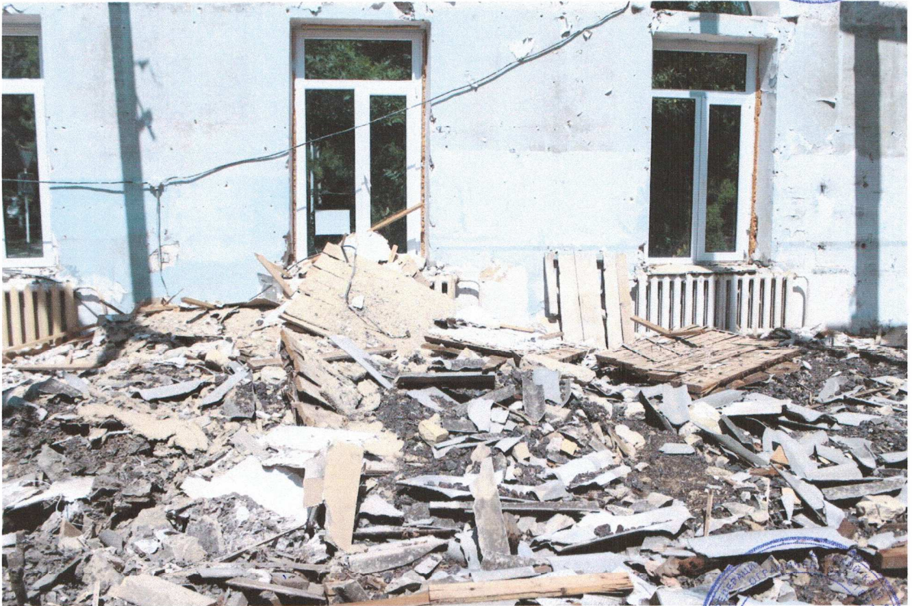
Фото №18. Строительный мусор после падения потолочного перекрытия.
