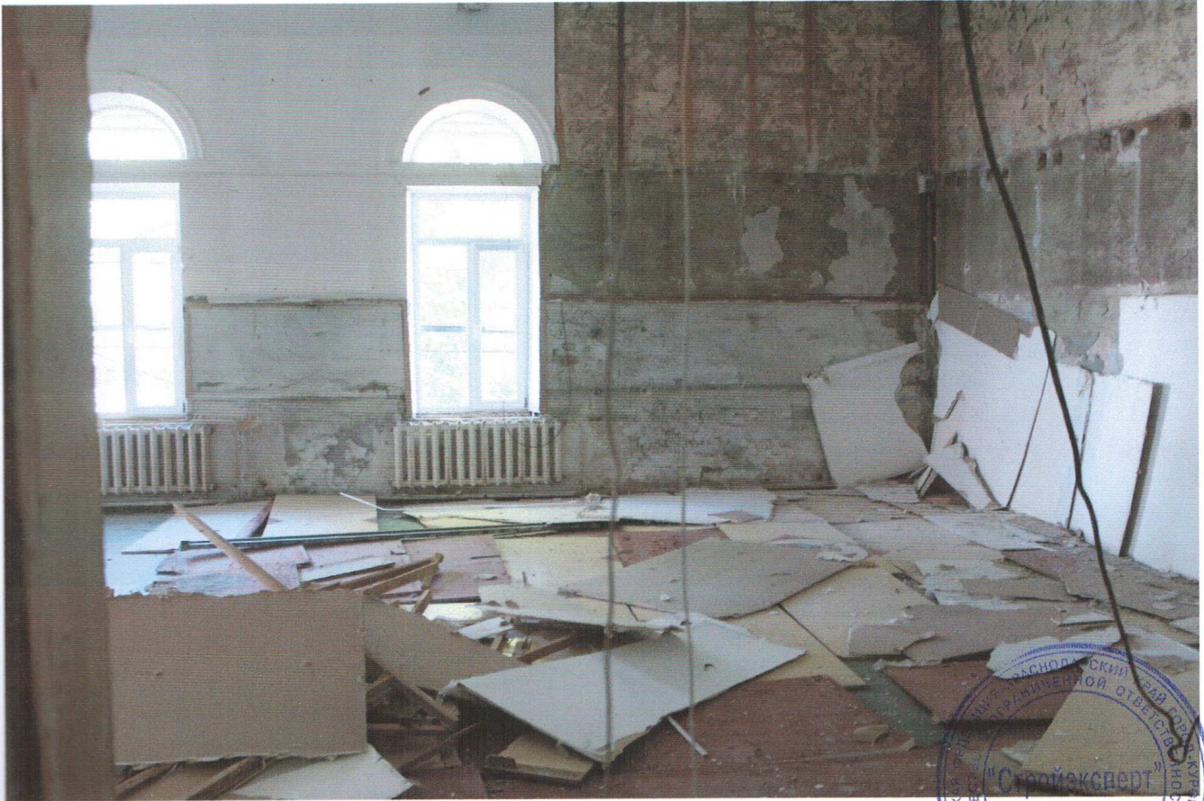
Фото №35. Демонтированные панели стен из ламинированного ДСП и обивка стен из листов ГКЛ.
