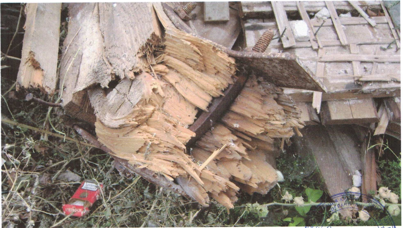
Фото №27. Место излома несущей деревянной балки.
