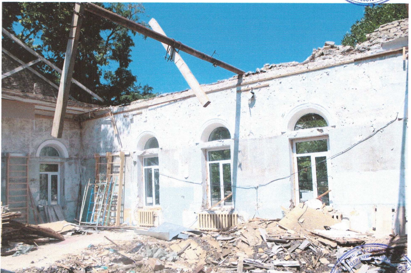
Фото №16. Здание спортивного зала после начала производства ремонтных работ съемка июль 2014 года.
