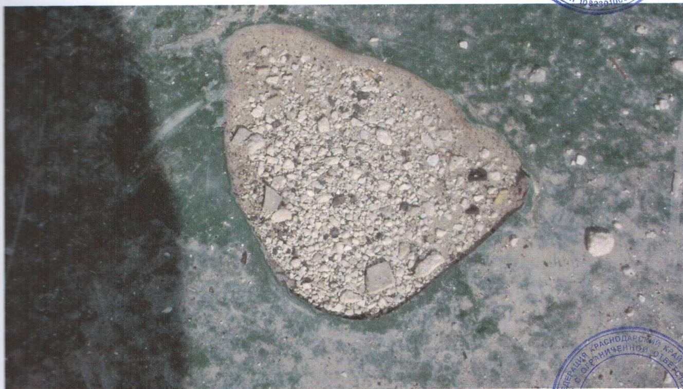
Фото №34. Место повреждения каучукового покрытия пола.
