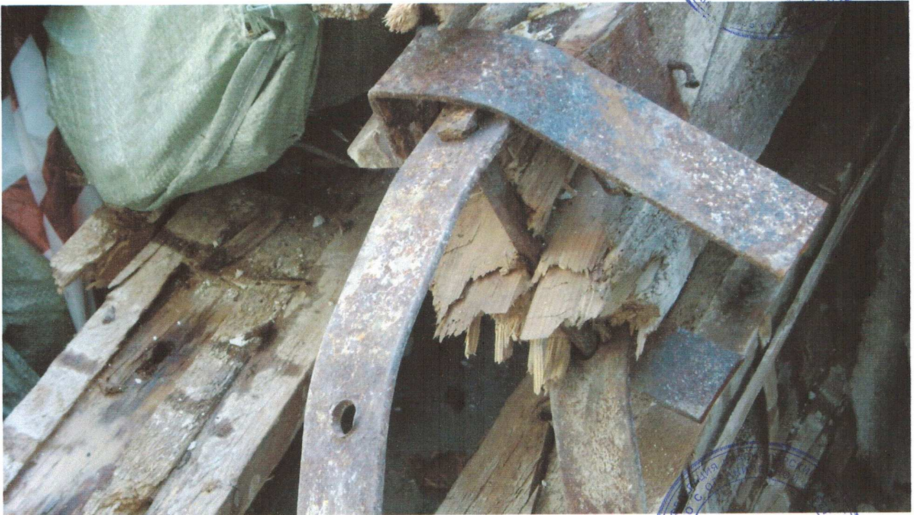
Фото №32. Место излома несущей деревянной балки.
