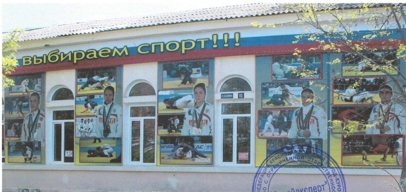
Фото №1. Здание спортивного зала до проведения ремонтных работ, съемка апрель 2014 года.
